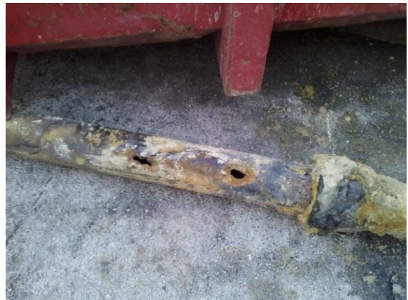
Etat du tube défectueux
