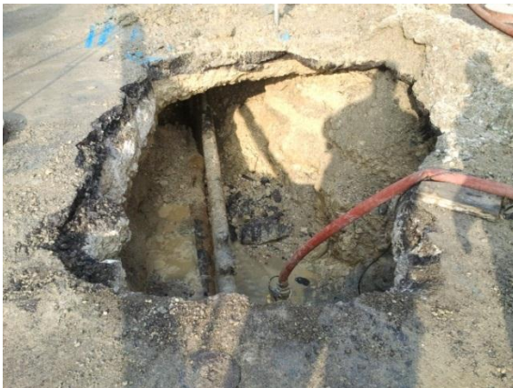
Fuite survenue le 8 février 2012
