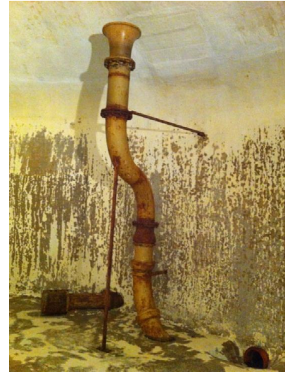
Trop-plein et crépine corrodés
